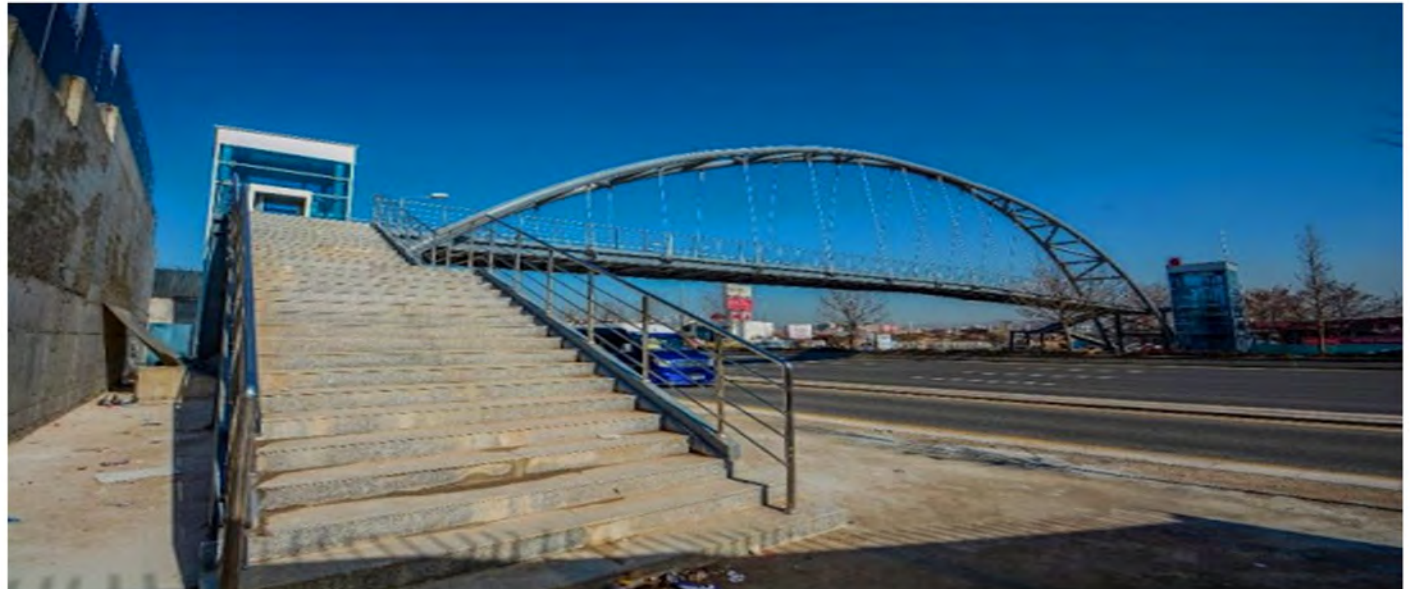
İstanbul Yolu Uçak Müzesi Yaya Üst Geçit Projesi 100 ton Çelik Konstrüksiyon İmalat ve Montaj Çalışma Faaliyetlerimiz Istanbul Road Aircraft Museum Pedestrian Overpass Project 100 tons Steel Construction Manufacturing and Installation Work Activities
